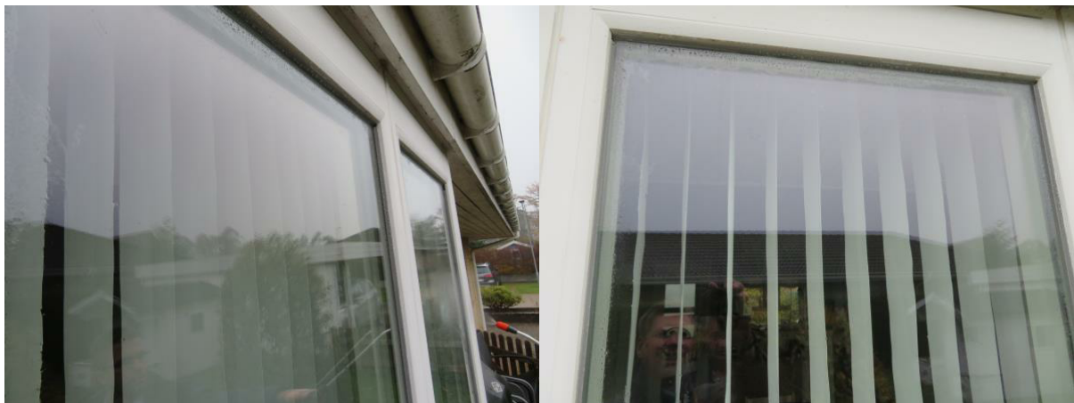
Result after spraying water on the other windows ... Résultat d'aspersion d'eau sur les autres fenêtres
